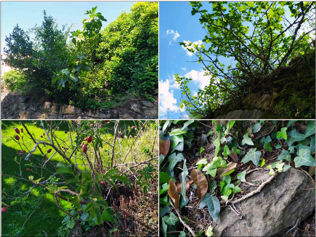
Fig. 4 - Aspetti di criticità legati alla presenza di specie legnose potenzialmente pericolose per il mantenimento del buono stato di salute delle strutture murarie.
